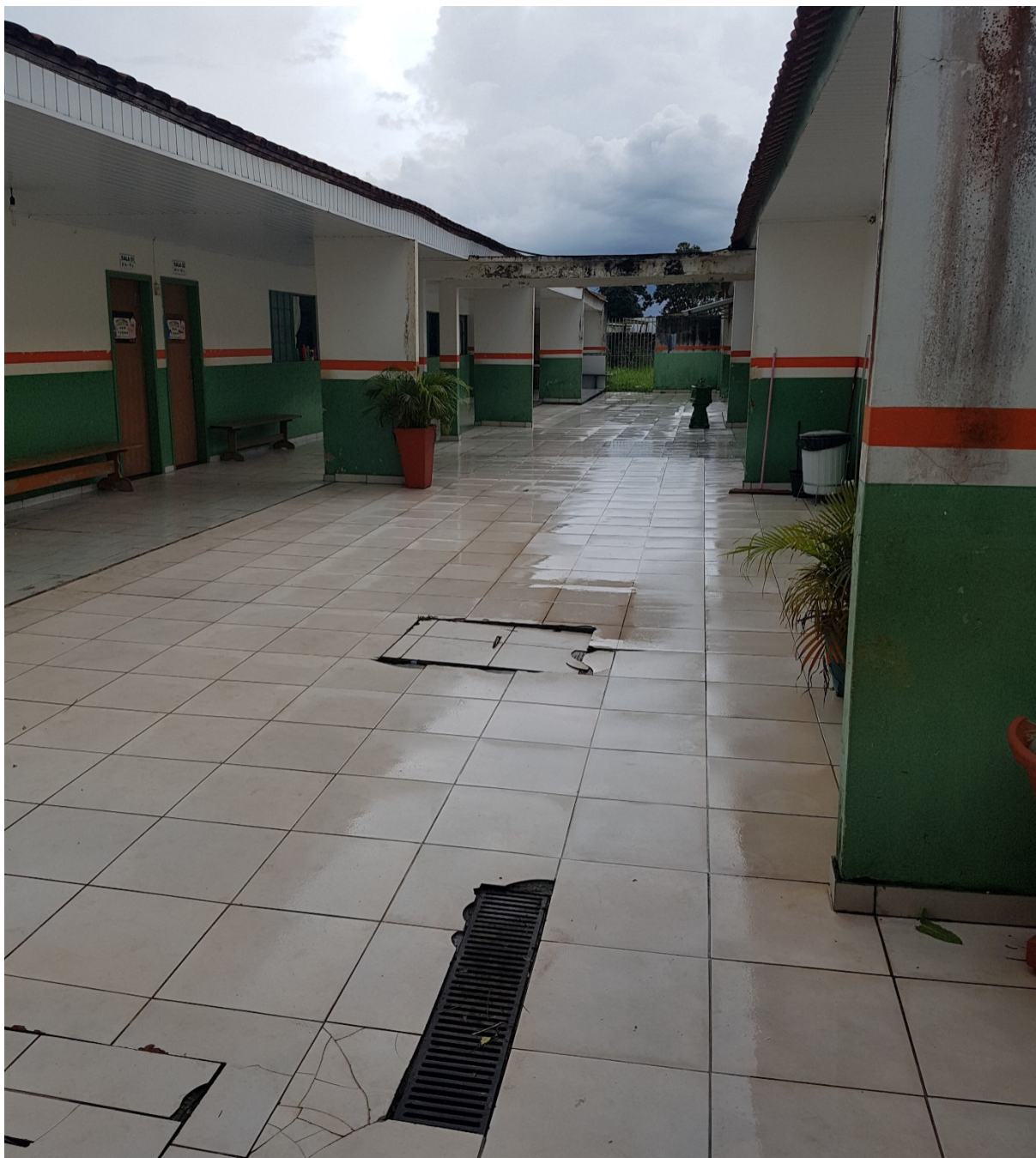
Área geral da escola, demonstrando a necessidade pintura, adequação do piso, telhado e calhas.
